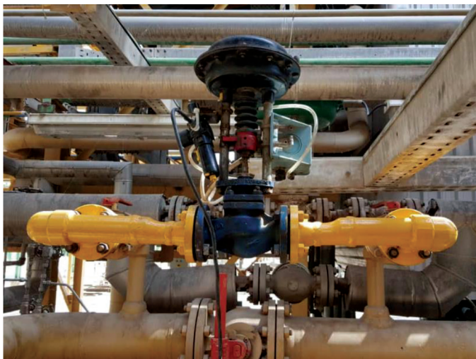
شکل ۶- کنترل ولو Pcv-۵۱۵
