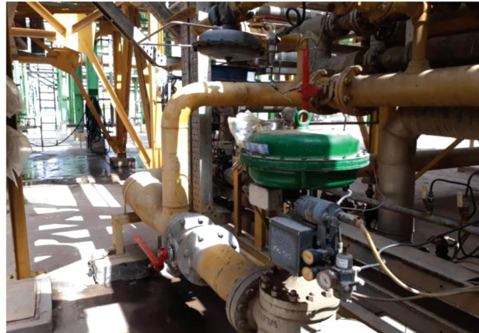
شکل ۵- کنترل ولو Fv-۵۱۵ خط اصلی گاز ورودی به بویلر
