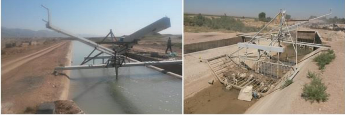
شکل ۳- نمایی از دستگاه تله‌انداز اجسام شناور
